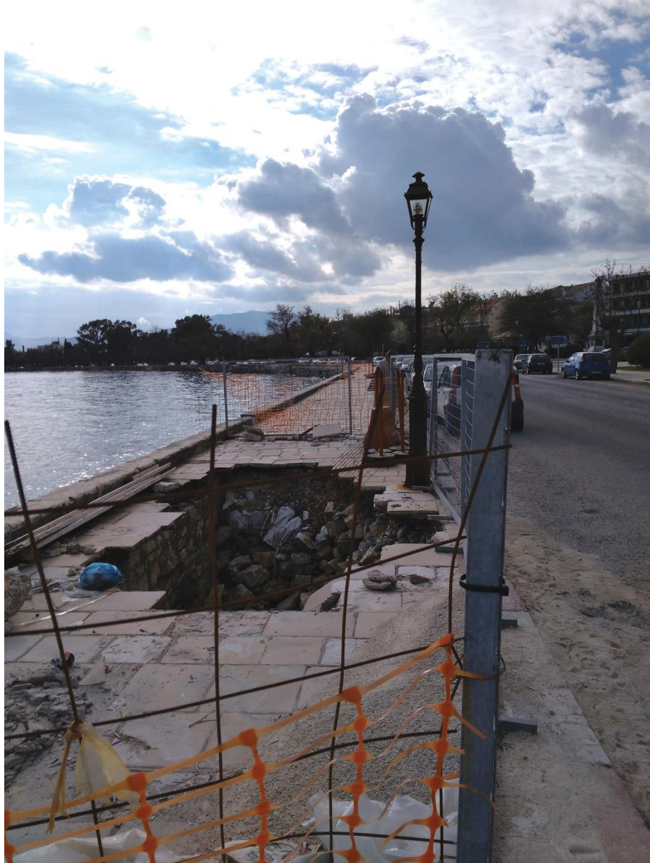
Οι επί δεκαετίες καθιζήσεις του πεζοδρομίου, ως συνέπεια των υποσκαφών στο παραλιακό κρηπίδωμα
