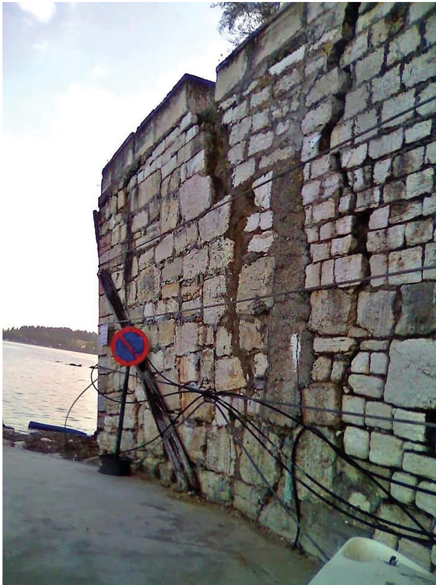
Ρηγματώσεις του 1992 στο κρηπίδωμα του κηπαρίου, έναντι CorfuPalace
